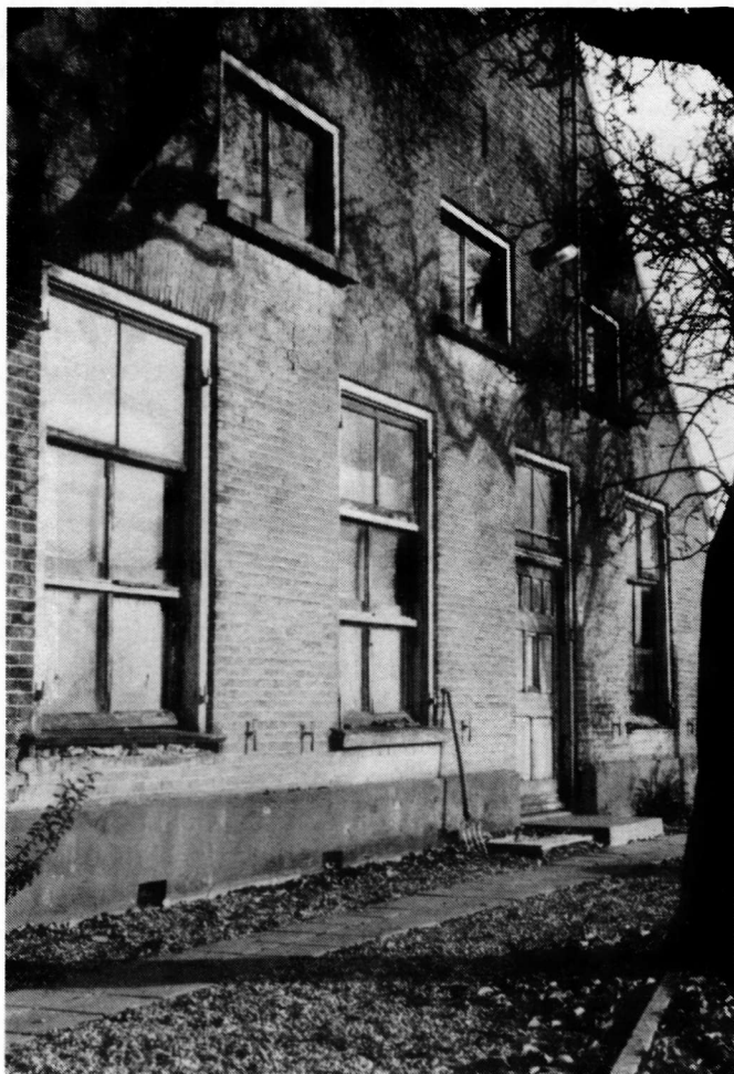
De voorgevel van "De Kleine Boel". De vensters zijn verdwenen.
